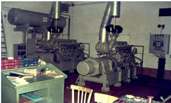
Notstromanlagen in Bereitschaftsbetrieb (1971)
