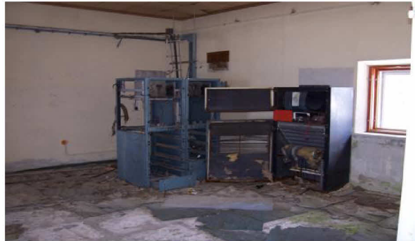
Microwave L.O.S. (Line of Sight) Gebäude 2006
