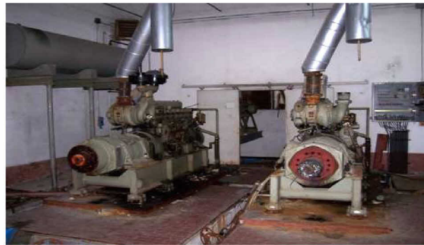
Notstromanlagen außer Betrieb (2006)
