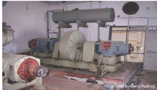
No-Break Anlage mit Tagestank für Diesellostoff für die Notstromanlage ( 2006 )
